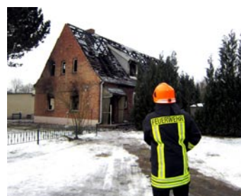
200.000 Euro Sachschaden sind bei dem Brand entstanden.
