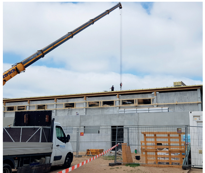
Die Schülerinnen und Schüler der Grundschule Lankow können sich freuen: die neue Sporthalle soll im Oktober fertig sein. © ZGM
