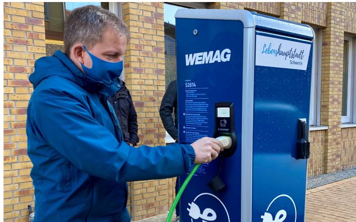
An der neuen Ladesäule am Stadthaus können gleichzeitig zwei Fahrzeuge an den Typ 2-Ladebuchsen Strom tanken. © LHS Schwerin/Jacqueline Saß
