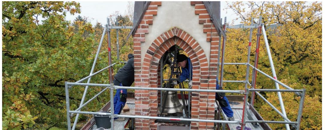
Uwe Griwahn (r.) und sein Kollege bei der Montage der Glocke im Turm der Trauerkapelle © formWeb.de/H. Weitendorf
